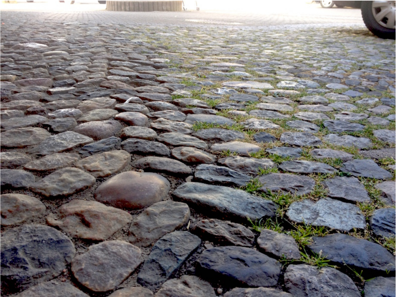
Abb. 2: Detailaufnahme der Grenzlinie zwischen mit Gras bewachsenen und kahlen Pflasterfugen, schräger Blickwinkel
